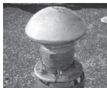
①劣化した防水継手
