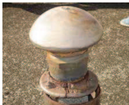
①劣化した防水継手
